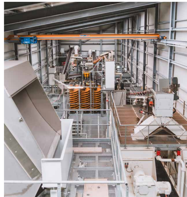
Système de tri moderne pour les déchets de construction dans l'installation de lavage des sols à Péry, dans le Jura bernois.
