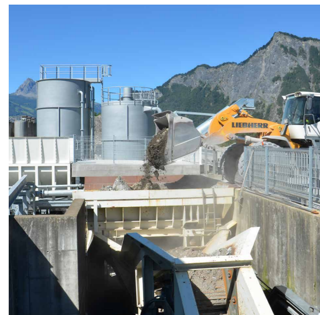
Installation de lavage de terres
