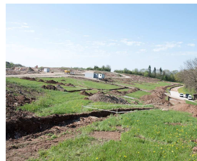
Tranchées de diagnostic afin d'estimer le potentiel archéologique sur le terrain d'une futur extension de carrière (VD)
