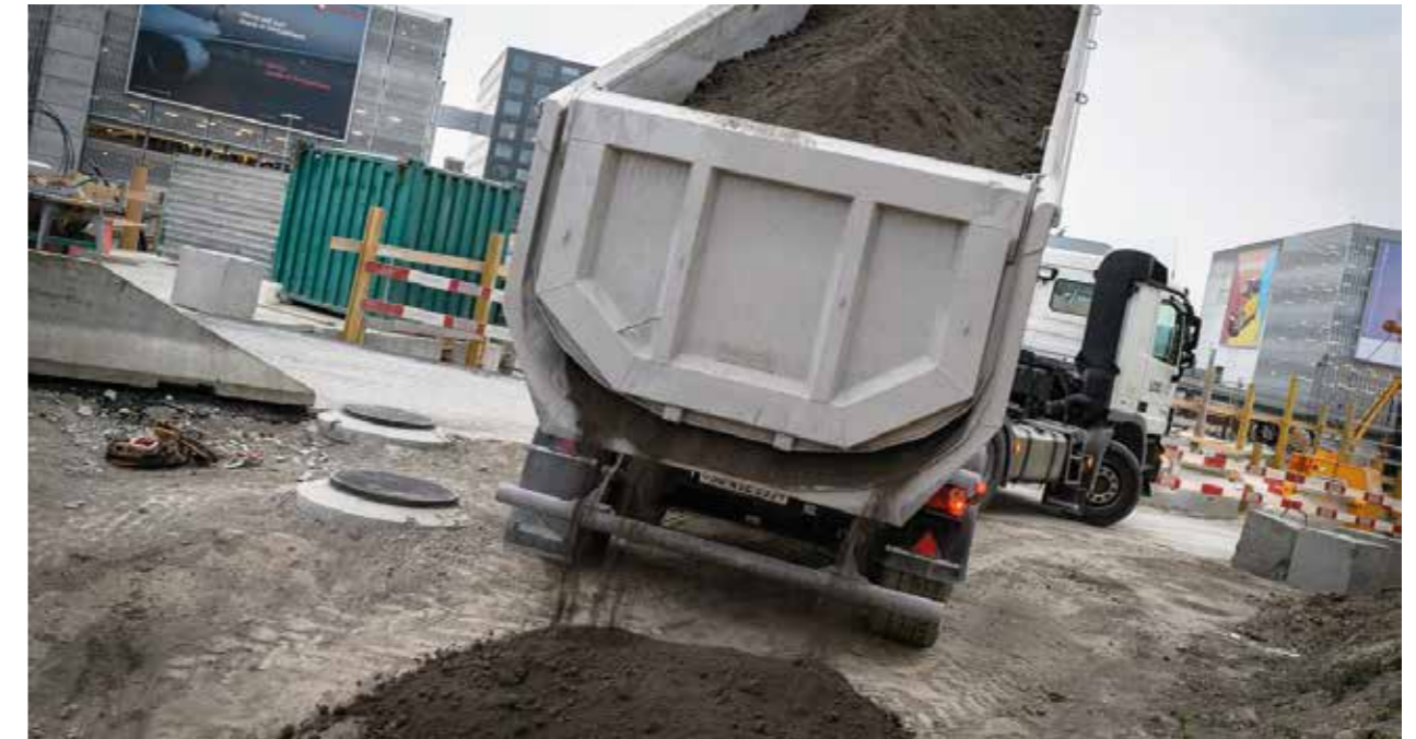
Beim grössten Hochbauprojekt der Schweiz, «The Circle at Zurich Airport», werden 10'000 m³ REB® Ragazer Erdbeton verbaut.
