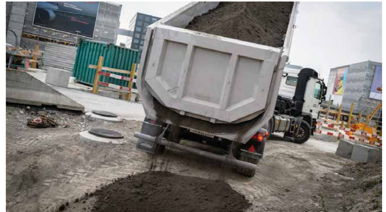
Dans le plus grand projet d'immeuble de Suisse «The Circle at Zurich Airport», on utilise 10 000 m³ de béton Ragazer REB®.
