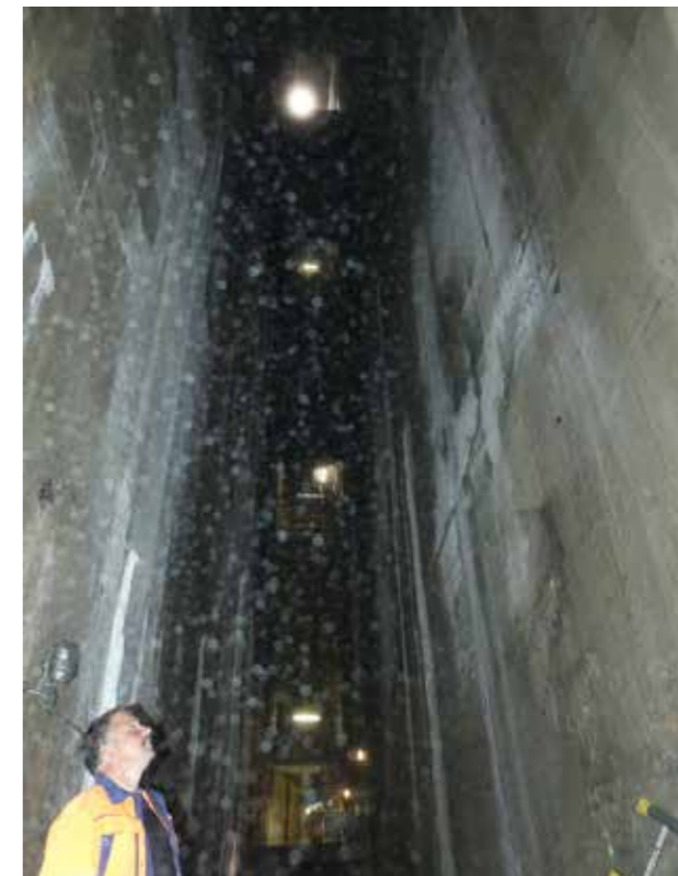
Comme sous un dôme: Peter Roth pendant sa visite dans le barrage Räterichsboden du Grimsel.
